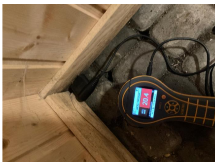
Fukt i trepanel på vegg.
