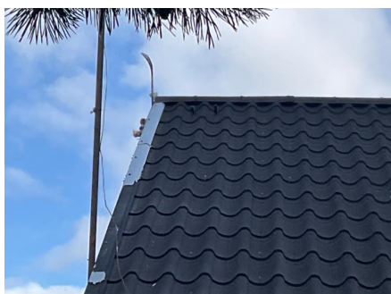
Stedvis flassende overflatebelegg på vindskibeslag og pipebeslag.
