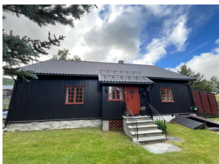
Det er kun montert snøfangere over hovedinngangen.
