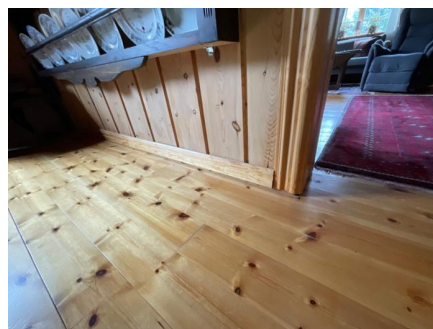
Glipper mellom gulv og gulvlist i spisestue.
