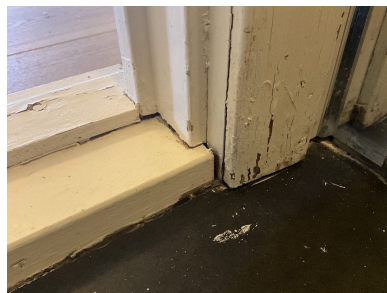
Bilde 15 — Oppkant ved dør. Ufagmessig utførelse.
