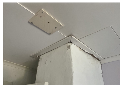
Bilde 24 — Søyle med avskallet maling og slitt overflate
