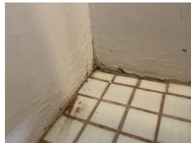
Bilde 8 — Målbart fuktopptak i hjørne av dusjbad
