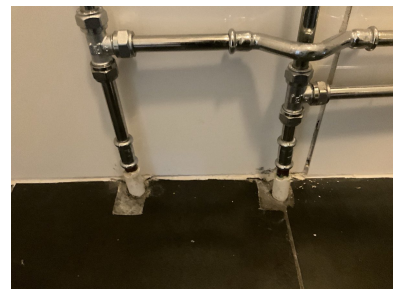
Bilde 16 — Eldre rør i overgang til nye
