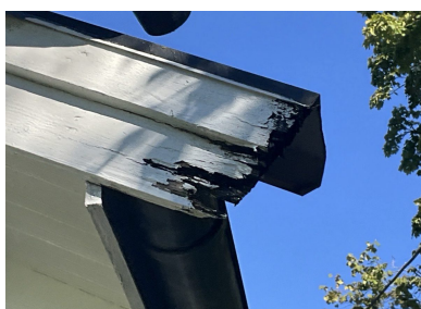
Bilde 5 — Råteskade i vindskie
