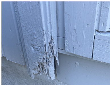
Bilde 2 — Råteskadet kledning 2
