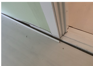
Bilde 22 — Ufagmessig utførelse ved legging av gulv/listverk
