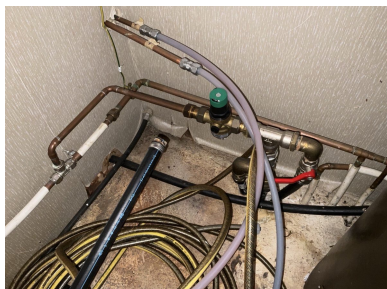
Bilde 28 — Rørinstallasjon med trykkreduksjonsventil og uoversiktlig røropplegg
