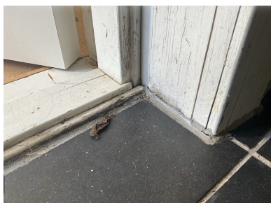
Bilde 10 — Terskel ved dør uten korrekt membranoppkant/utførelse
