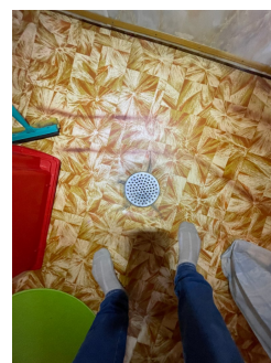
Skader og svakke i belegget ved sluk.
