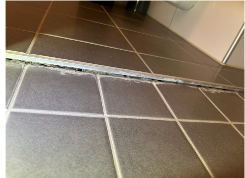
Manglende fuging i dusjens nedsenk.
