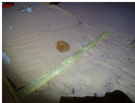
Fuktmerke rett under luftelyr
