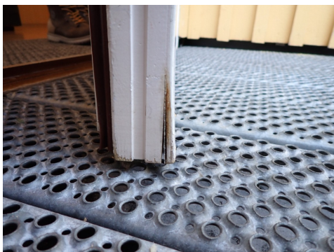
Begynnende fuktskade på inngangsdør
