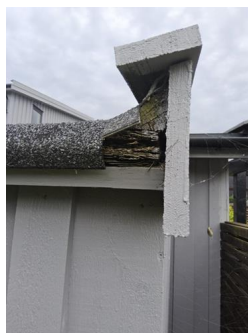
Yttertak og takkonstruksjon - Fuktskader.
