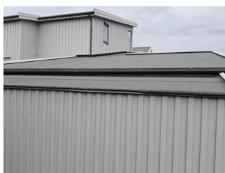
Yttertak og takkonstruksjon - Manglende avrenningsmulighet.
