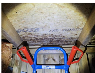
Innvendige forhold - Fuktmerker.
