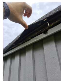
Yttertak og takkonstruksjon - Fuktskader.
