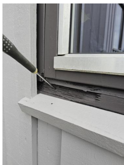
Vinduer, dører og porter - Råteskader.
