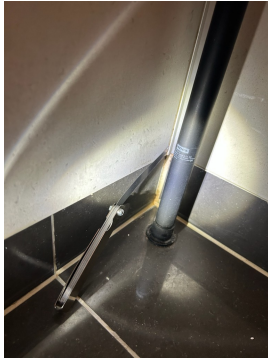
Manglende fuging bak hjørnelist.
