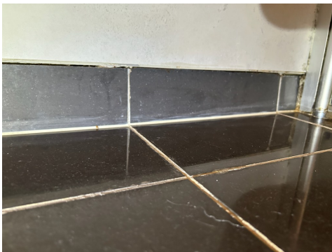
Manglende fuging mellom sokkelflis og bunnskinne på baderomsplatene.
