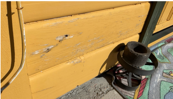
Værslitasje, hull i kledning
