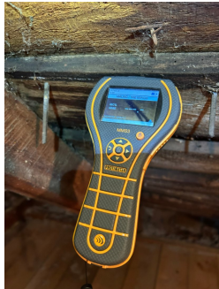
Ikke fuktutslag, sted med fuktskjolde
