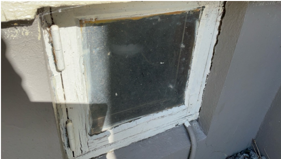
Værslitt, eldre vindu
