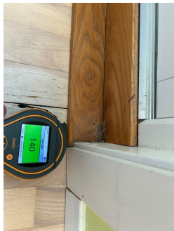
Fuktskada parkett, ingen indikasjon om fukt befaringsdagen
