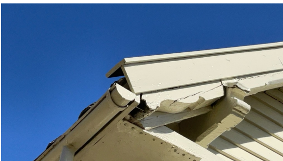
Sperre og bjelkeende - indikasjon om mulig fukt/råteskade
