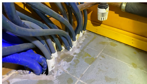
Rørgjennomføringer, ikke fuktsikring langs vegg
