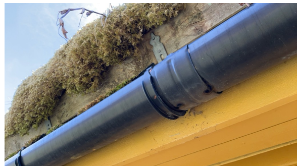
Tegn til punktvis lekkasjer
