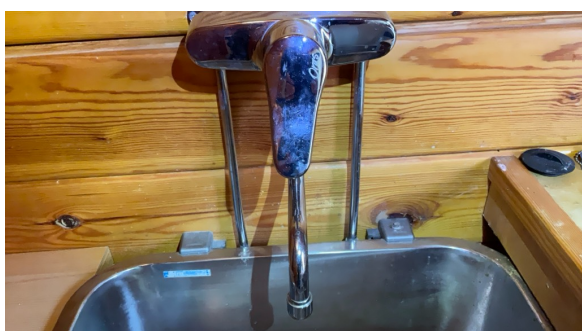
Manglende tettesjikt våtsone bakvaskekar
