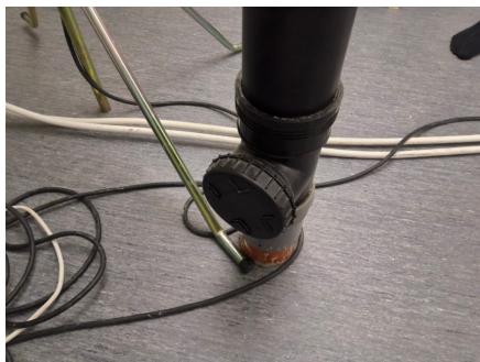
Stakeluke plassert i kjeller vaskerom.
