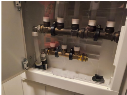
Fordeler skap montert i utleiedel.
