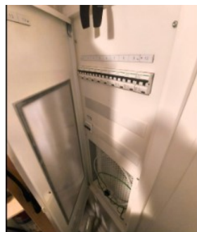
Sikringsskap utleiedel montert tekniskrom.
