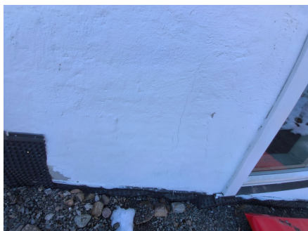
Sprekker/riss ble registrert på grunnmur.
