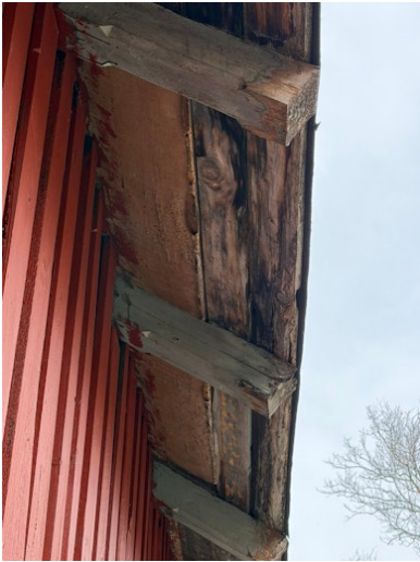
Tegn på råte i undertak og sperrestokker.
