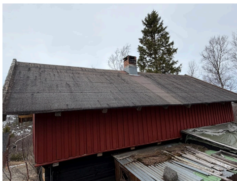
Manglende takrenner og nedløp
