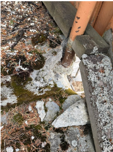
Støp rundst festepunkter for rekkverk har løsnet.
