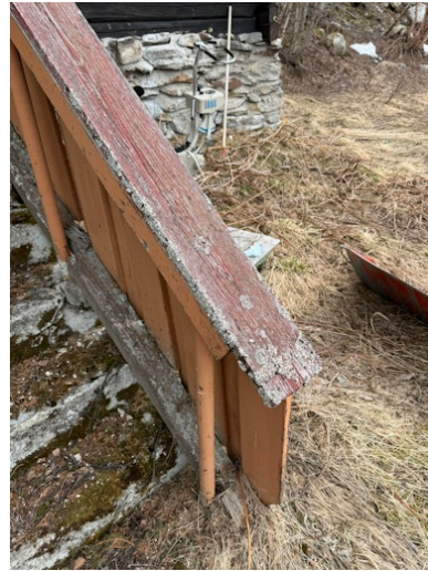
Råte i konstruksjonen avdekket.
