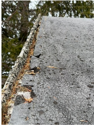
Oppsprukket og krakkelert tekking.
