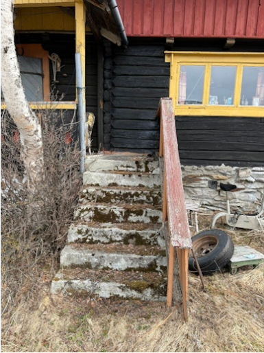
Utvendig trapp bærer preg av slitasje og manglende vedlikehold.
