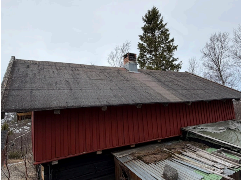
Baksiden av taket med tydelig mosedannelse.
