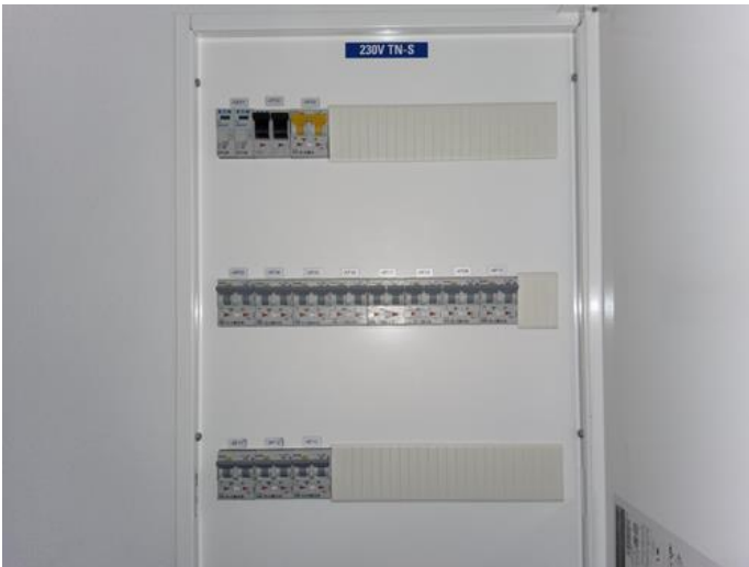
Elektrisk anlegg - [Sikringskap ]
