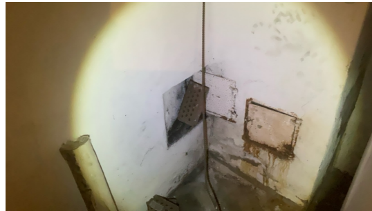
Bek-lekkasje under feieluke kan tyde på at det bør fjernes aske etter feiing.
