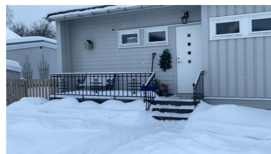
Støpt trapp og plating med smijernsrekkverk ved hovedinngang. Rekkverk med høyde under 90 cm.
