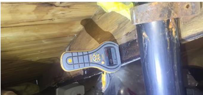
Loft - uinnredet / råloft - [Lekkasje på loftet ]
