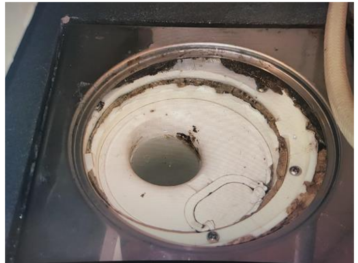
Våtrom - [Sluk på badetrommet ]
