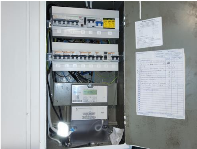
Elektrisk anlegg - [Sikringskap ]
