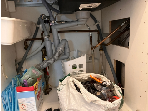
Det er ikke montert lekkasjedetektor på kjøkken
