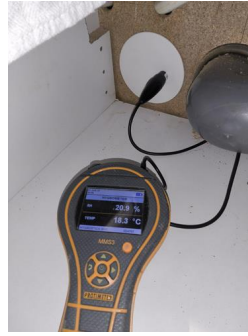
Utført kontroll i tillegg konstruksjon - IMG_20260209_111501
