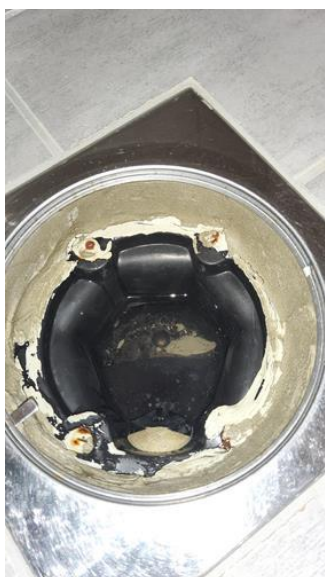
Avløpsrør (ink. sluk) - [Sluk bad underetasje]
