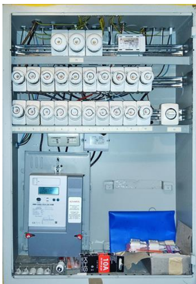
Forenklet vurdering av det elektriske anlegget - [Sikringskap]
