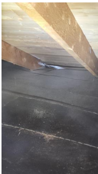
Overflater vegger/undertak - [Is-kondensmerker på kaldtloft]
