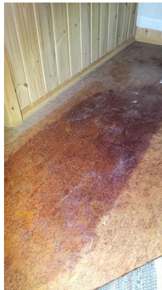
Overflater gulv - [Misfarging i belegg i gang]
