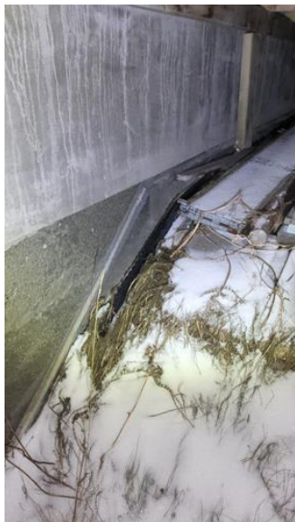
Helhetsvurdering - [Løs fuktsperre under terrasse]
