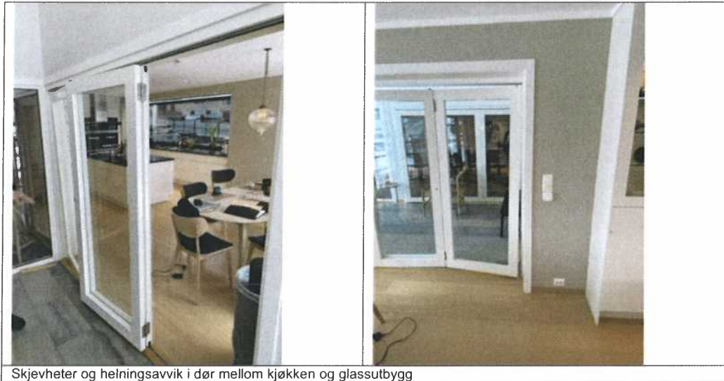
Skjevheter og helningsavvik i dør mellom kjøkken og glassutbygg
