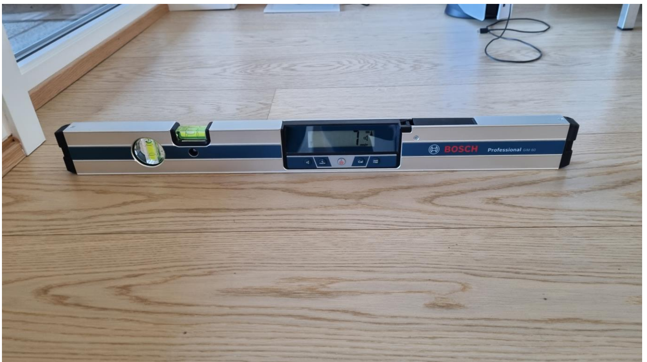
På innsiden av skyvedør mot balkong i 2.etasje er det en helling innover som tilsvarer 7 mm/m.
