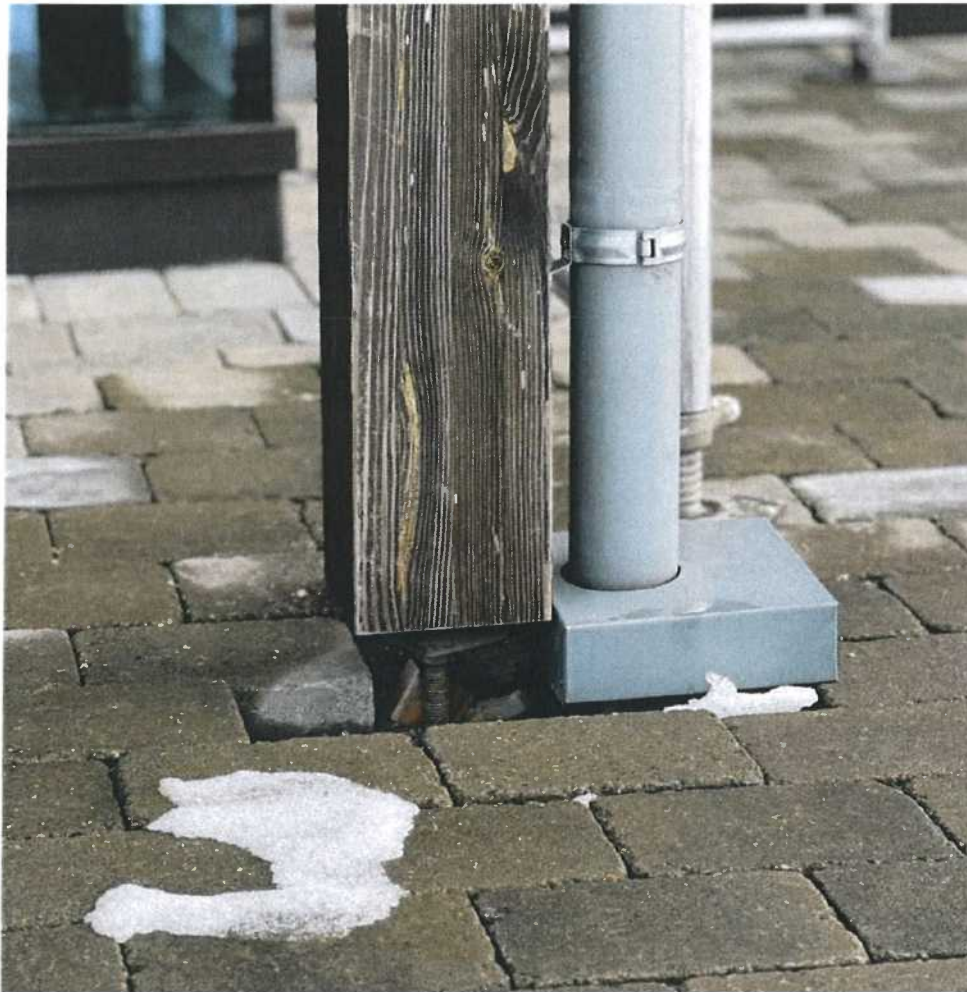
Figur 6, Foto fra befaring 19.2.2024 som større setninger i grunnen enn søylefundament
