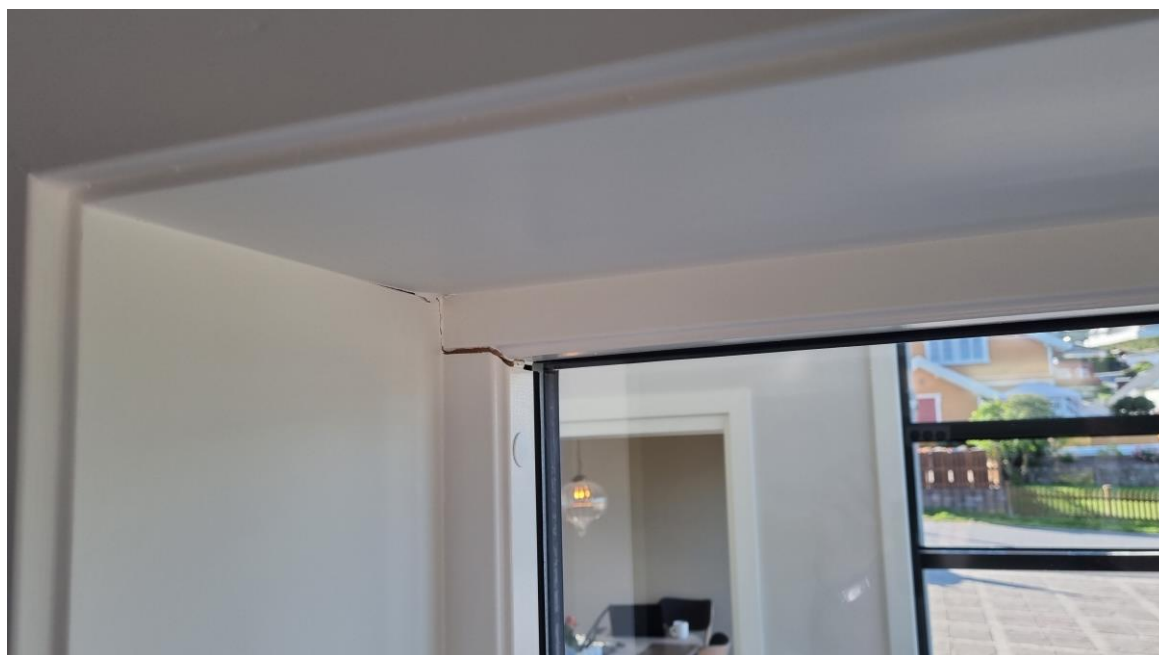
Dette bildet er fra forkant av boligen. Her har sig medført at karmen har sprukket i sammenføyningen på grunn av sig i grunn. Dette har ifølge eier oppstått nylig og kan tyde på pågående bevegelser. Måling på gulv under denne fastkarmen viser helling på 9 mm/m.
