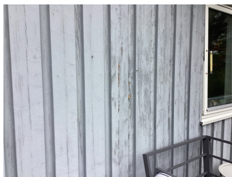
Mangled utvendig vedlikehold på hele boligen
