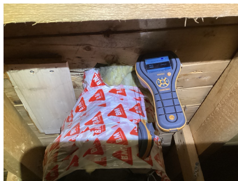
Gjennomføring avlufting hatt. mugg rundt gjennomføringen og stort treverk. men ingen for høyet fukt i tre verket.
