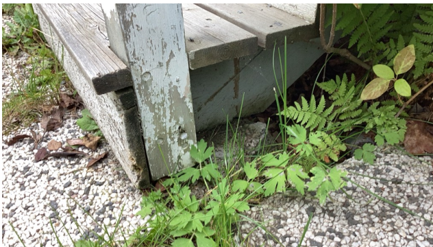
Fuktopptrekk og noe råteskadet.
