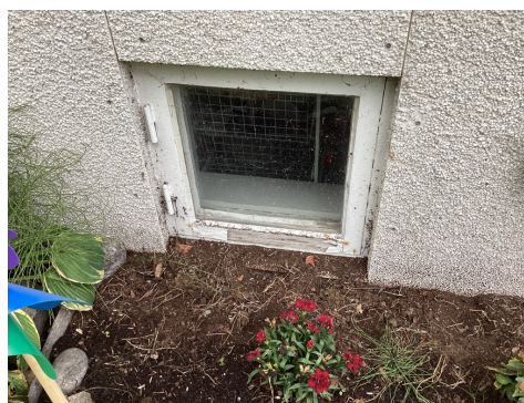
Koblet vind må byttes.
