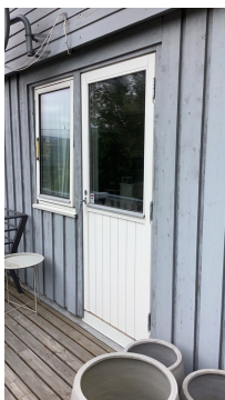
Terrassedør med maling avfalkking og fukt optrekk
