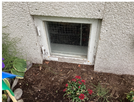
Koblet vind må byttes.
