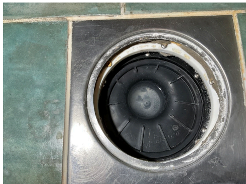
Sluk i dusjsone.
