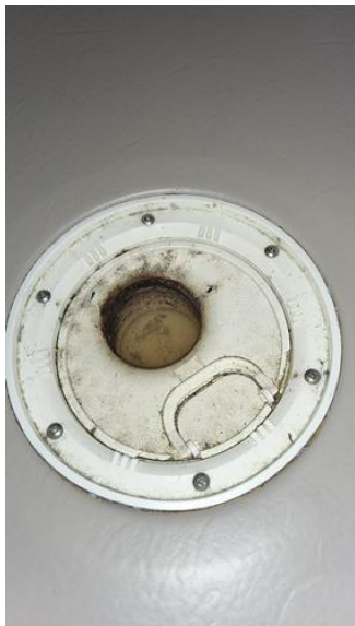
Avløpsrør (ink. sluk) - [Sluk bad 1. etasje]
