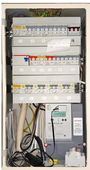
Forenklet vurdering av det elektriske anlegget - [Sikringsskap]
