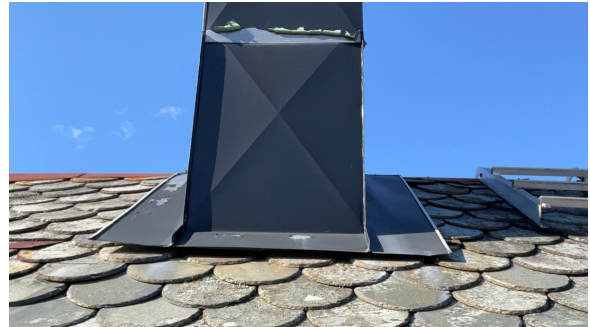
Utilstrekkelig festet pipebeslag og avskalling av overflatebehandling.
