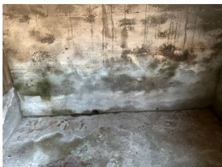
Fuktskjolder/misfarging på veggoverflater i kjelleretasjen.
