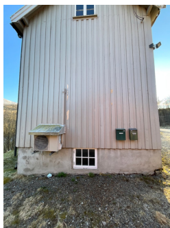
Det er påvist punktvis avskalling av maling.
