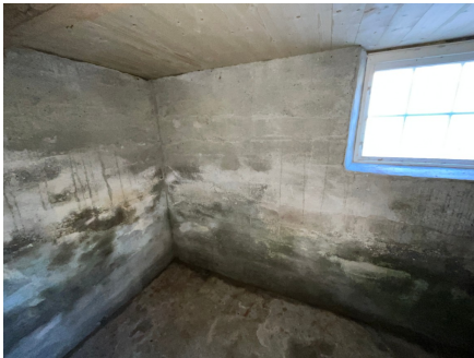
Misfarging av grunnmur innvendig.
