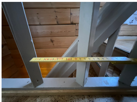
Åpning over 10 cm. innvendig rekkverk.
