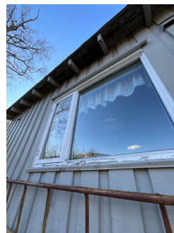
Malt trevindu med kombinert fastkarm med 2-lags isolerglass og åpningsvindu med koblet glass på kjøkken. Slitte karm og sprekker i treverket.
