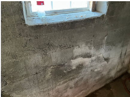
Setningsskader på grunnmur i kjellerrom.
