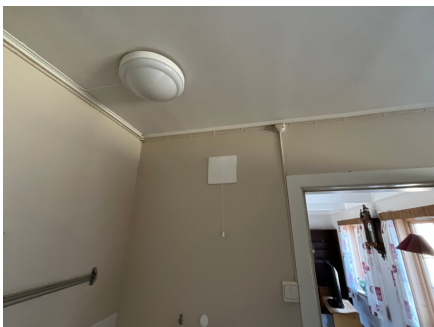
Naturlig avtrekk ved kokesone.
