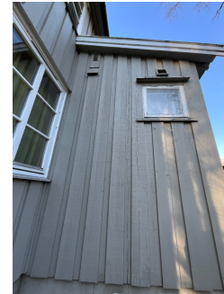
Det er påvist værslitt og oppsprukket trekledning
