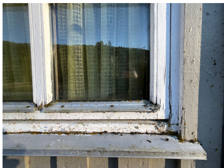
Vindu fra 1987 med råteskade på stue i 1. etasje mot nordvest.
