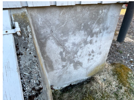
Setningsskader på grunnmur utvendig ved kjellernedgang.
