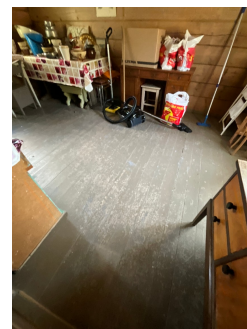
Stor slitasje/avflassing av maling på tregulv på stue mot vest i 1. etasje.
