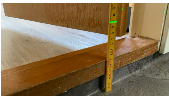
Måling av fall. målepunkt ved dørterkel.
