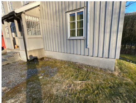
Manglende fuksikring og bortledning av vann fra tak og taknedløp
