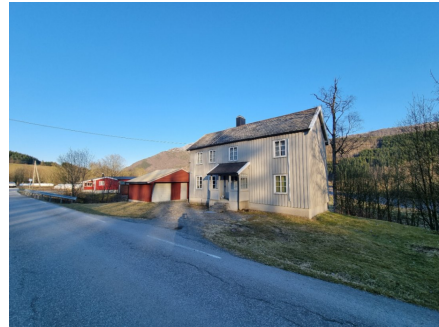
Det er påvist dårlig fall eller flatt terreng inn mot grunnmur.
