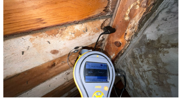
Ingen tegn til forhøyet fuktverdi i taktro og sperrer ved eldre fuktskjolder.
