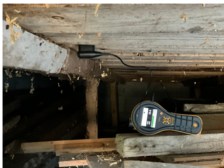
Fuktmåling i stubbloftsbord viser 15,4%.
