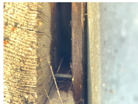
Det er påvist manglende musesperre.
