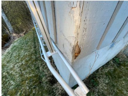
Det er påvist spredte råteskader i bordkledningen.
