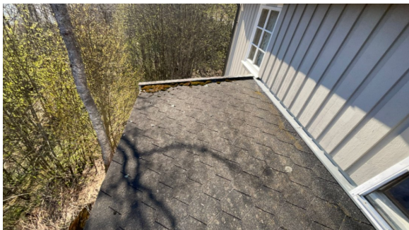
Pappshingeltak over kjøkken og bad. Bildet viser vekst av mose.
