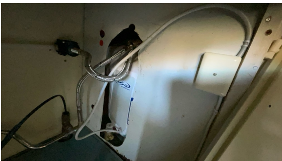
Varmtvannsbereder montert i benkeskap.
