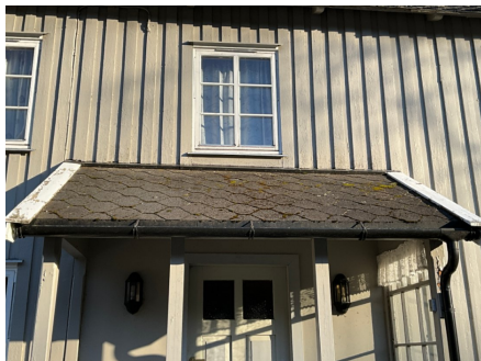
Pappshingeltak over trapp. Bildet viser vekst av mose.
