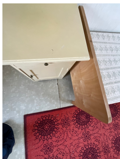
Oppsprekking gulvbeleggsskjøt på soverom i 2. etasje.
