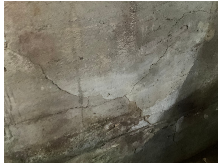
Setningsskader på grunnmur i kjellerrom
