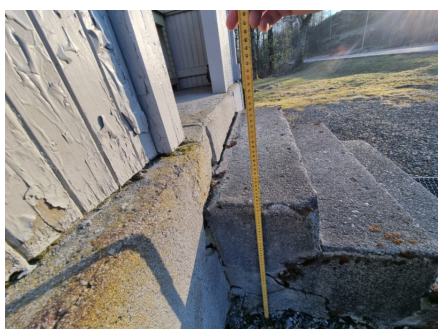
Manglende rekkverk utvendig trapp.
