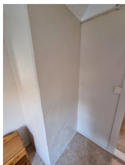
Pipe på soverom i 2. etasje. Kun. 3 synlige pipevanger.
