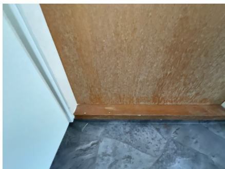
Våtrommet mangler tilluftsventilering
