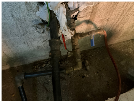
Stoppekran ved vanninntak i kjeller.
