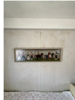
Oppsprekking av tapet på vegg på soverom i 2. etasje.
