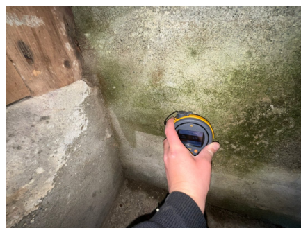
Fuktindikasjon på veggoverflater i kjelleretasjen.
