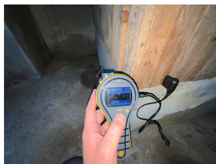
Fuktmåling i trekledning tett inntil betong med fuktopptrekk.
