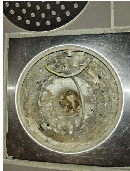
Avløpsrør (ink. sluk) - [Sluk vaskerom ]
