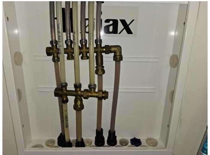
Tekniske anlegg, VVS anlegg (Sjekkpunkter utover det som er inkludert i andre rom) - [Fordelerskap rør-i-rør system ]
