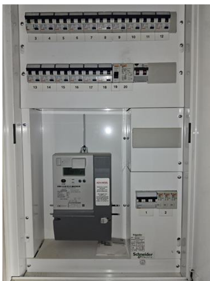
Elektrisk anlegg - [Sikringskap ]
