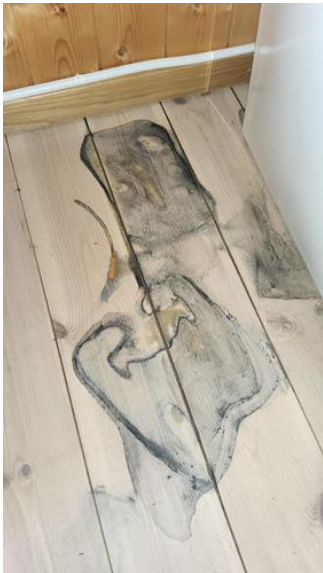
Overflater gulv - [Misfarging i gulv på hems]
