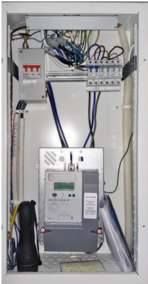
Forenklet vurdering av det elektriske anlegget - [Sikringsskap]
