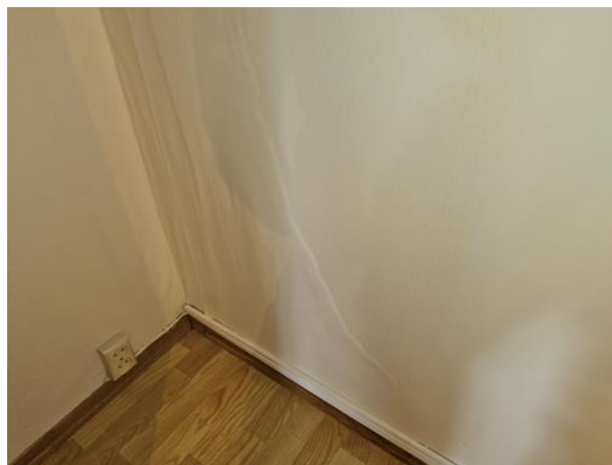
Konstruksjoner (tilfarergulv, himling og vegger). - [Fuktskade på vegg]
