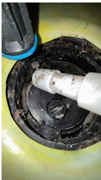
Avløpsrør (ink. sluk) - [Sluk bad]
