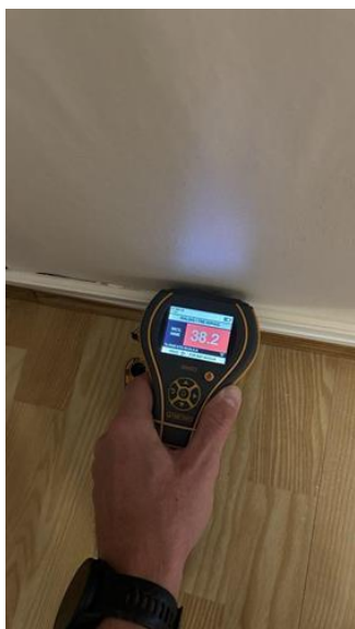
Konstruksjoner (tilfareergulv, himling og vegger). - [Fuktmåling i vegg stue]
