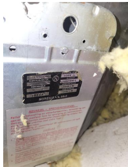
Tekniske anlegg, VVS anlegg (Sjekkpunkter utover det som er inkludert i andre rom) - [Info VVB]
