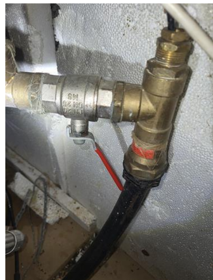
Tekniske anlegg, VVS anlegg (Sjekkpunkter utover det som er inkludert i andre rom) - [Stoppekran og vannledning]
