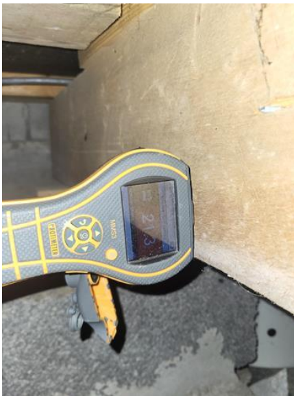
Krypekjeller - [Fuktmålinger i treverket over 20 %]
