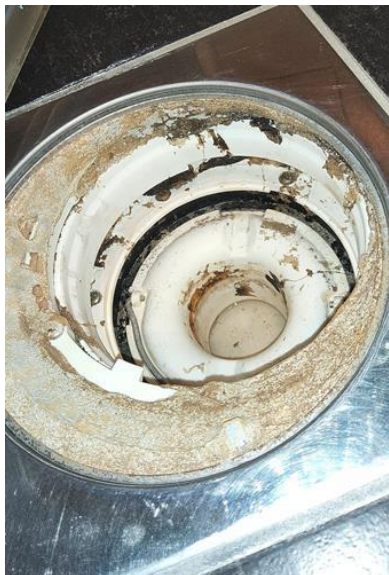
Avløpsrør (ink. sluk) - [Sluk bad 1. etasje]
