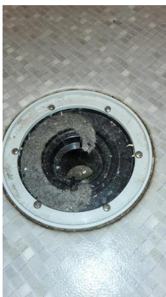
Avløpsrør (ink. sluk) - [Sluk vaskerom utenfor dusjonen]
