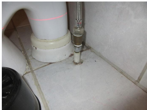
Riss i flis ved rørgjennomføring.
