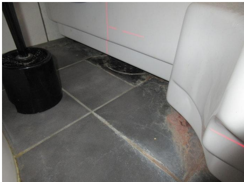
Sluk under dusjkabinett
