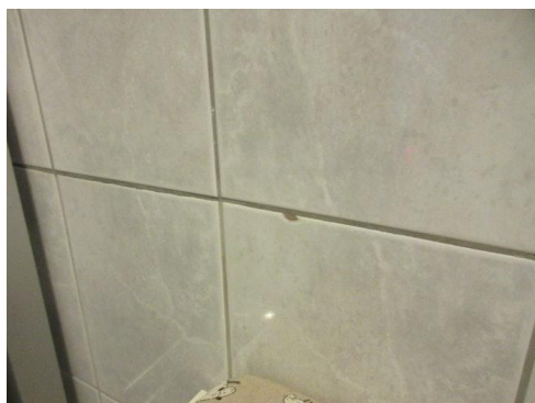
Hakk i flis på vegg.
