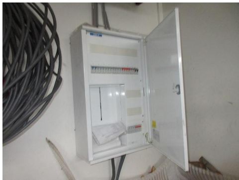
Sikringskap i sokkeletasjen
