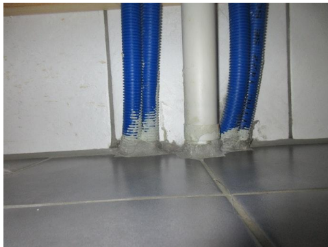
Rørgjennomføringer i gulv.
