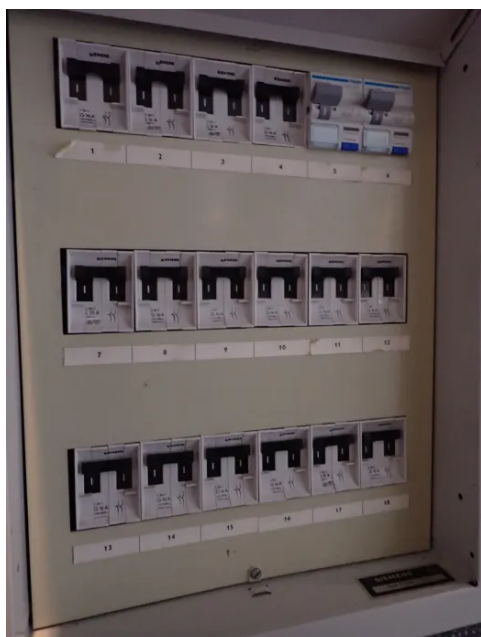
Sikringsskap på kjøkken
