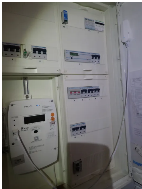
Sikringsskap i kjellertrapp
